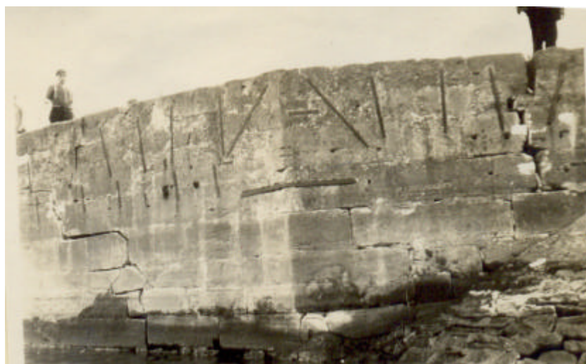
Weiteres schadhaftes Mauerwerk
