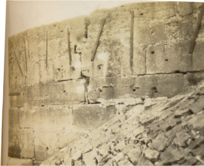
Schadhafte Stellen im Kaimauerwerk des Kranen
