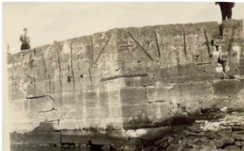
Weiteres schadhaftes Mauerwerk
